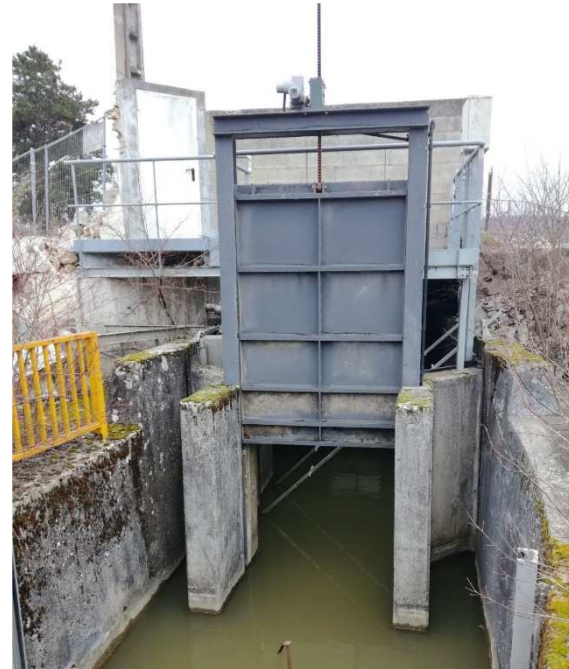
Des équipements hydrauliques vieillissants.
