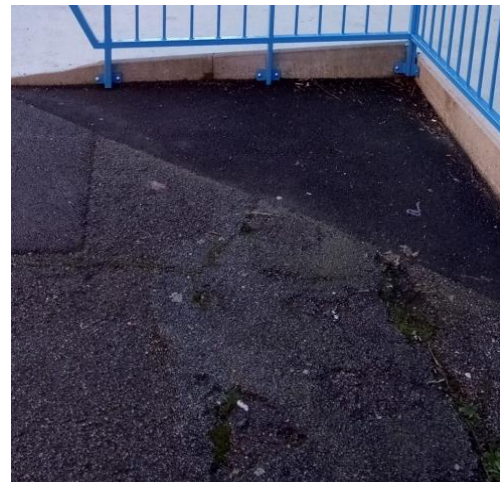
Revêtement de la cour usé
