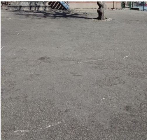
Marquages au sol effacés
